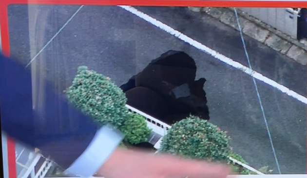
調布市道路に生じた陥没
