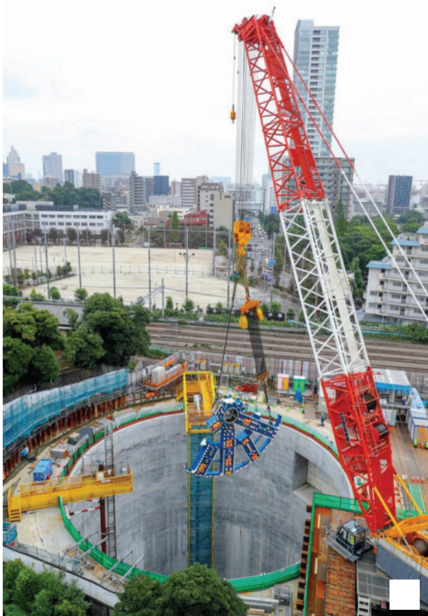
大深度地下でのリニア中央新幹線のトンネル工事の準備が進む北品川非常口=2020年7月、東京都品川区、JR東海提供
